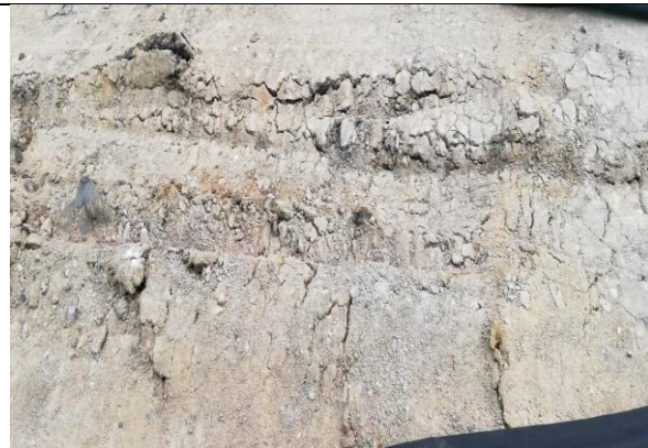
Ilustración 68. Fallos en la subrasante.
