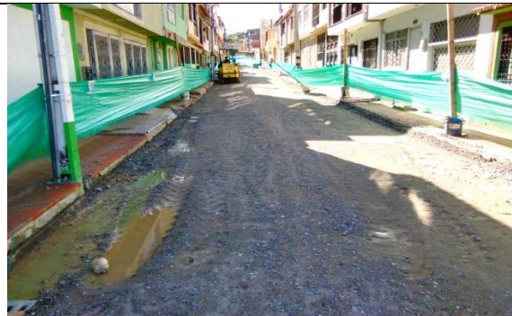
Ilustración 32. Suspensión de actividades con maquinaria en la vía por lluvias
