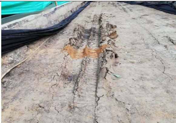
Ilustración 67. Fallos en la subrasante.
